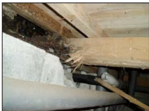
浴室土台の被害例
