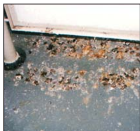
フンによる被害状況
